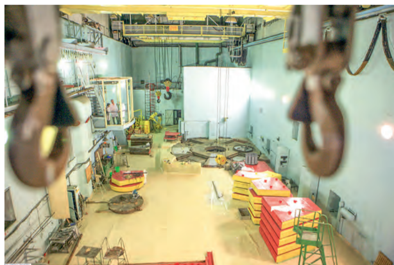
Центральный зал АЭС
